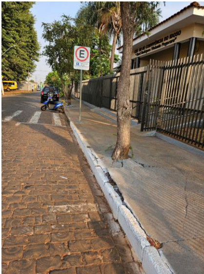
Calçada com alto relevo e rachadura
