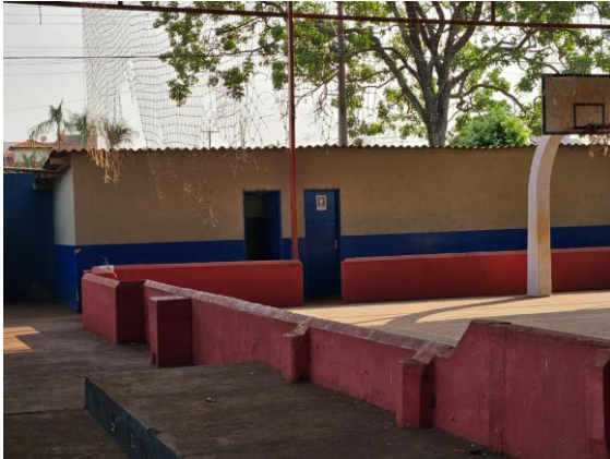
A quadra está com a tela danificada, pela metade
