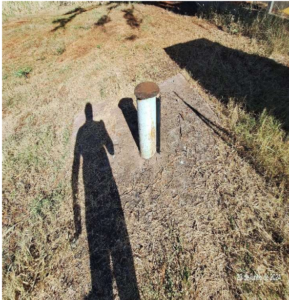
Poço para captação de água sem bomba
